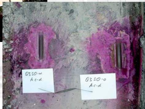
Untersuchung der Alkalität an freigelegten Spanngliedern
